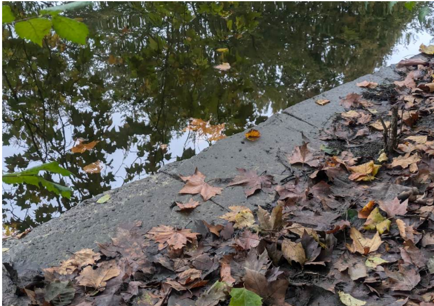
Figuur: Bestaande oever is overwoekerd, oeverbeschoeiing van mergelsteen nog maar op enkele plekken zichtbaar
